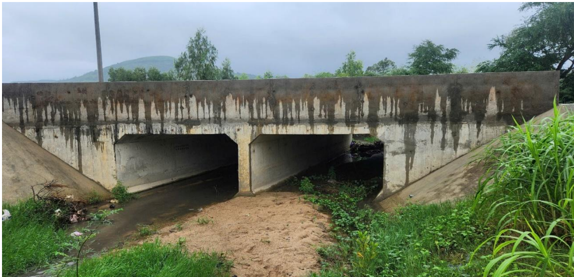
Hiện trạng công thoát theo suối phía Đông Chùa An Hòa 2(3x2)m
